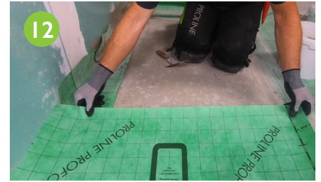
12 Appliquer la natte d'étanchéité et de désolidarisation PROFOLIO sur les surfaces du sol (observez les instructions de la fiche technique 523 PROFOLIO avec PROFIX DS).
